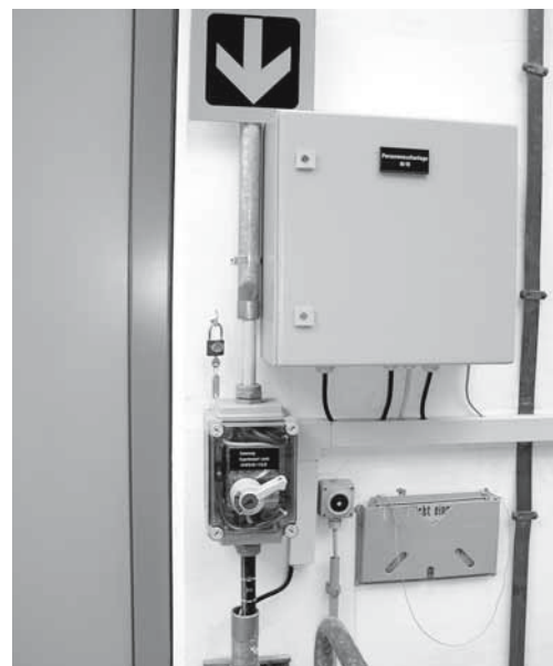
Fig. 4: interrupteur du pont roulant pouvant être verrouillé en position déclenchée afin d'empêcher toute mise en marche intempestive.
