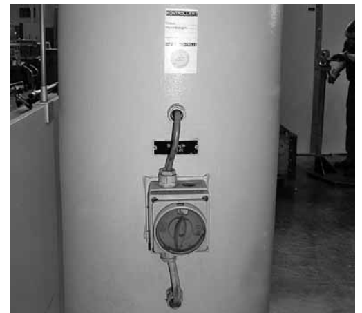
Figure 7: interrupteur pouvant être verrouillé en position déclenchée afin d'empêcher toute mise en marche intempestive.
